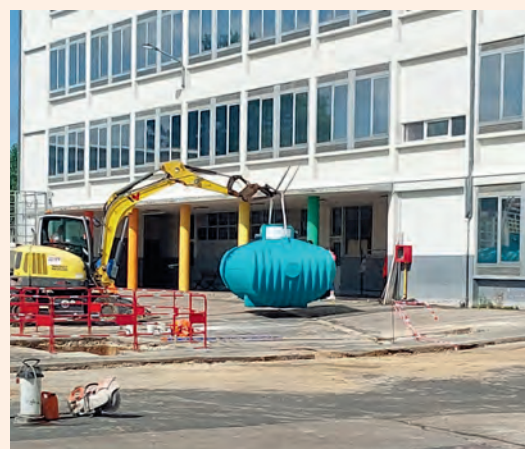
Une réserve d'eau de 10 m 3 a été installée. Elle permettra de récupérer les eaux de pluie.
